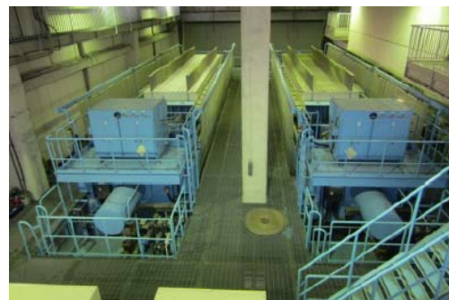
図 11 排水処理施設の主要設備（脱水機）
