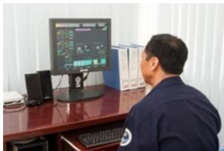
① アズビル株式会社 フエ省水道公社の浄水場に導入した SCADA システム (薬品の自動注入システム制御)
